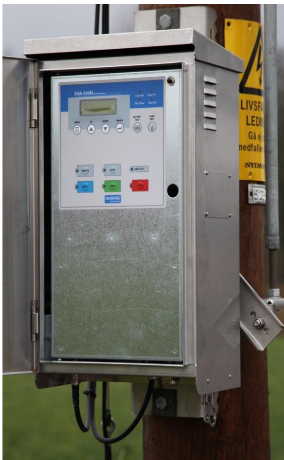
EOA 500 – monterad på trästolpe
