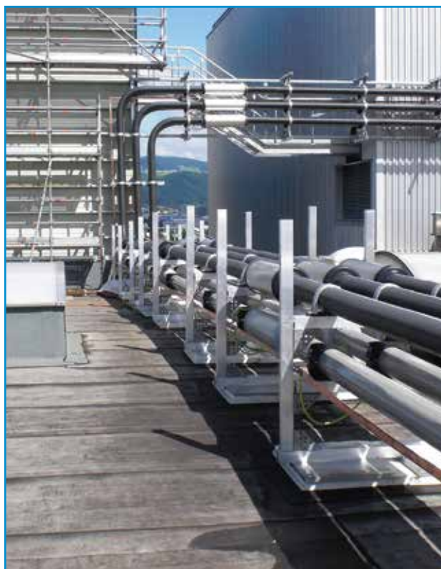
Austria - GUD Linz: 12kV - 4500A
